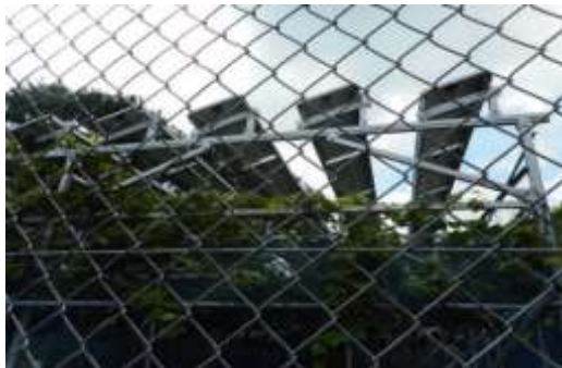
畑の上部に設置した太陽光パネル
